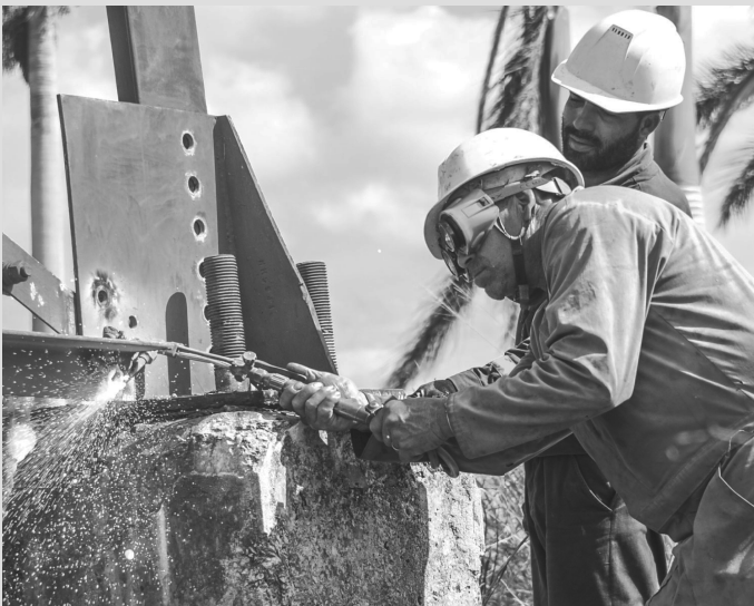
Die Hochspannungstürme erlitten durch die starken Winde des Hurrikans Rafael bei seinem Durchzug durch Artemisa schwere Schäden
