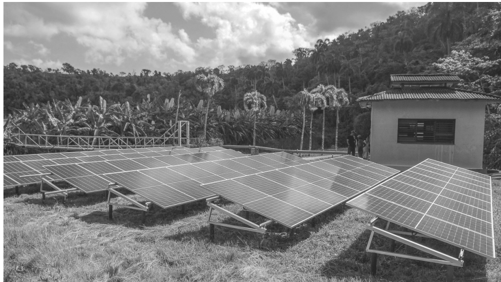
Pumpstation mit erneuerbarer Energie in der Provinz Artemisa FOTOS: JOSE MANUEL CORREA
