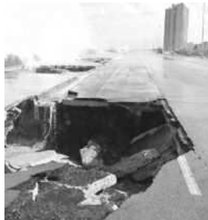
Schwere Schäden am Malecón
